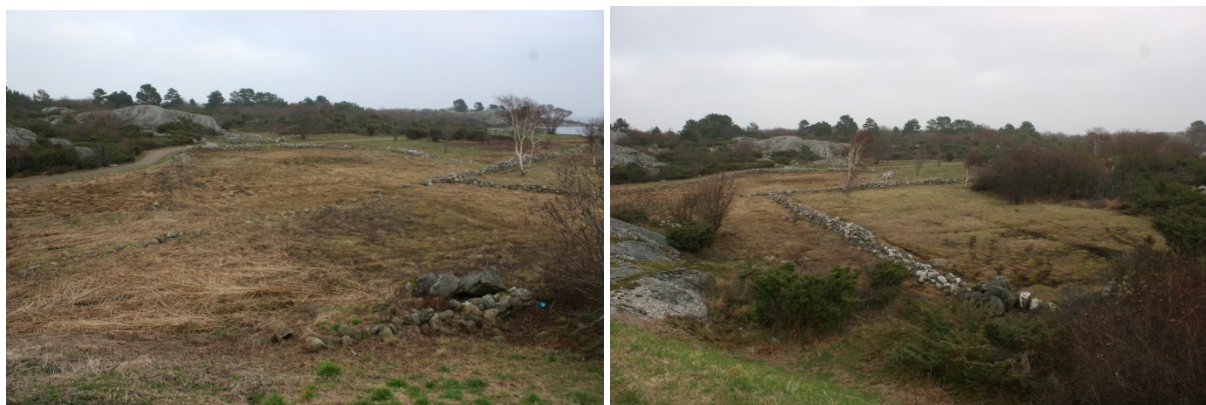
Figur 7: Bilden t. vä. visar EH från Fotövägen med den felaktigt upplagda muren löpande ut åt höger. T. hö. Ses den felaktiga muren och hur dominerande den är i vissa vinklar. Foto förf.
